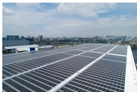
ダイナベース太陽光発電設備設置状況
