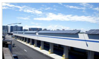
太陽光発電設備
