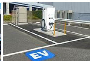
EV急速充電スタンド
