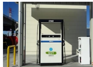
板橋トラックターミナル CNGディスペンサー
