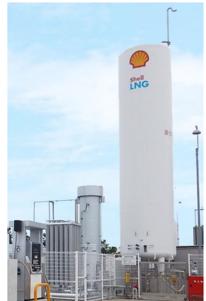
京浜トラックターミナル LNGタンク
