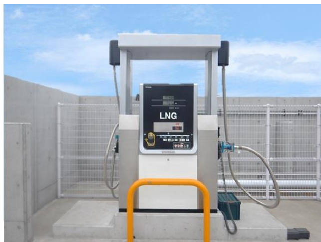
LNGスタンド
