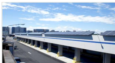
荷扱場 太陽光発電設備
